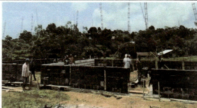
Foto 2: Vista del estado actual de las paredes del aula, se observa la necesidad de puertas, ventanas, y de la instalacion del techo.
