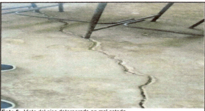
Foto 5: Vista del piso deteriorado en mal estado.
