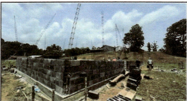
Foto 3: La comunidad ha iniciado con fondos propios a reparar las paredes a la espera de que con el programa de mantenimiento se puedan terminar las paredes y asi contar con aulas adecuadas para los niños.
