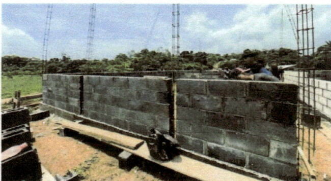
Foto 4: Sin la ayuda del programa de mantenimiento no se logrará reparar las paredes por lo que esperamos contar con su ayuda y asi mejorar la educacion de los niños.
